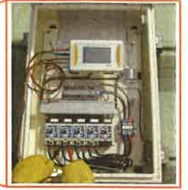
接続箱のブレーカー端子 (モジュール側)で測定。
